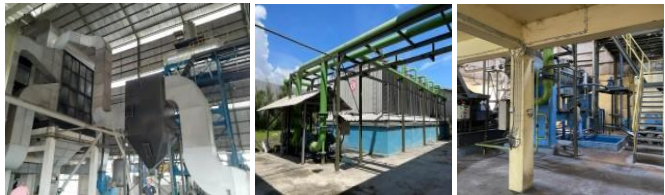
Pabrik Palembang, Sumatera Selatan. Tenaga Listrik tenaga sekam padi dengan kapasitas 3MW
